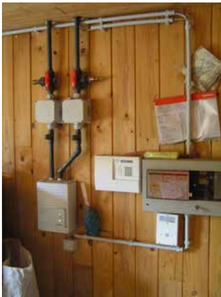
Abb. 3: Durch eine Brandschutzmeldeanlage konnte auf den Bau einer aufwendigen Brandwand mit Brandschutztor verzichtet werden (Foto: Witzel)
