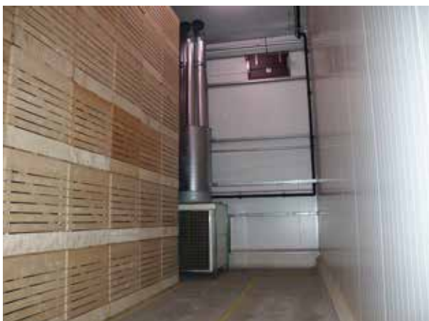
Abb. 6: Raumbelüftung von offenen Großkisten über eine Mischlufteinheit (Foto: Peters)
