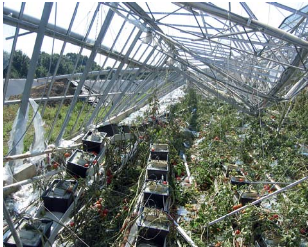
Abb. 1: Totalschaden an einer modernen Gewächshausanlage durch extreme Windgeschwindigkeiten eines lokalen Tornados
