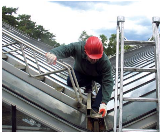
Abb. 5: Zum sicheren Auf- und Absteigen auf ein Gewächshausdach muss die Leiter 1 m über den Anlegepunkt hinausragen Fotos (2): Berufsgenossenschaft
