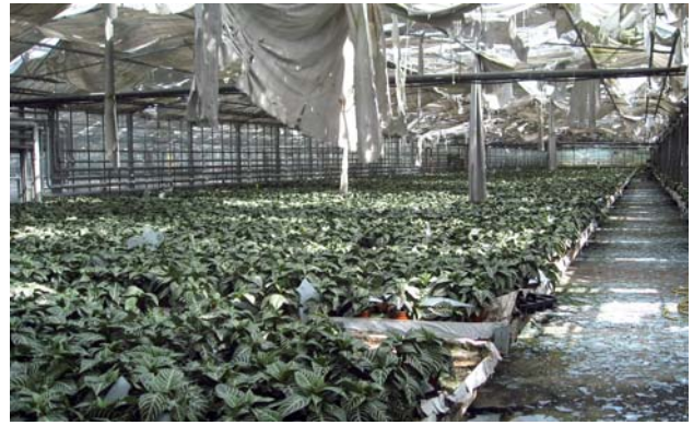
Abb. 2: Hagelschaden am Bedachungsmaterial, damit einhergehend auch starke Schädigung der Kulturen und der Inneneinrichtung – hier insbesondere des Energieschirms
