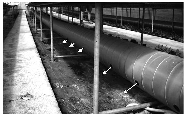
Abb. 4: Luftverteilungskanal unter dem Tisch.
