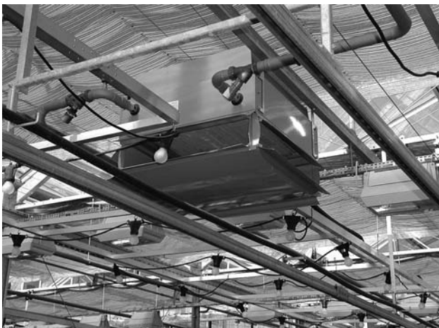
Abb. 12: Deckenluftheizer mit vierseitigem Ausblas.
