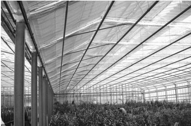
Abb. 3: Gewächshaus mit hoher Rohrheizung.
