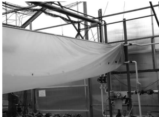
Abb. 13: Wandluftheizer mit gelochtem Folienschlauch.
