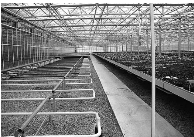
Abb. 4: Untertischrohrheizung bei Roll-Mobiltischen.
