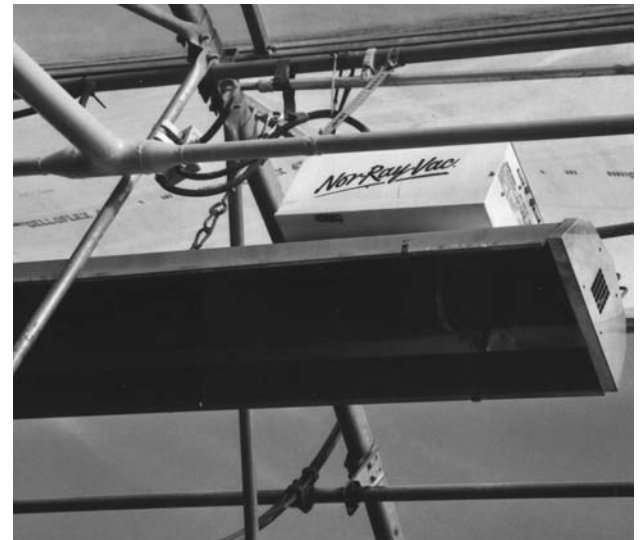
Abb. 11: Strahlungsheizung in einem Foliengewächshaus.
