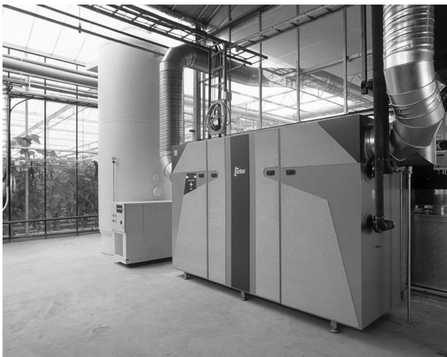
Abb. 13: Mikrogasturbine mit einer elektrischen Leistung von 100 kW.
