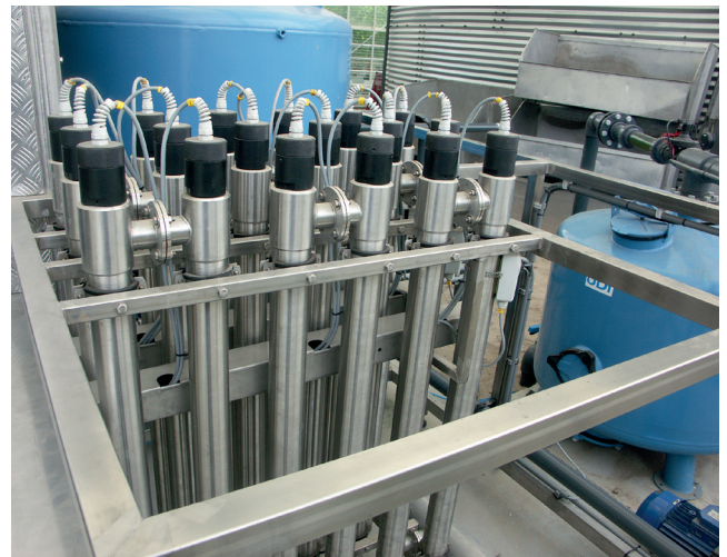
Abb. 3: Modular aufgebaute Niederdruck-UV-Anlage (Foto: Domke)
