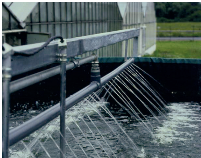
Abb. 6: Rohwasserzulauf eines Langsamfilters (Foto: Wohanka)
