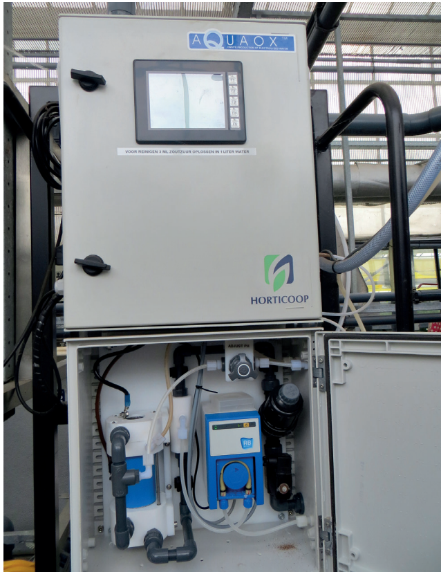
Abb. 7: ECA-Anlage zur Chlorung (Foto: Wohanka)
