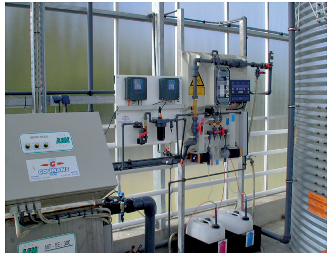
Abb. 10: Chlordioxidanlage (Foto Wohanka)
