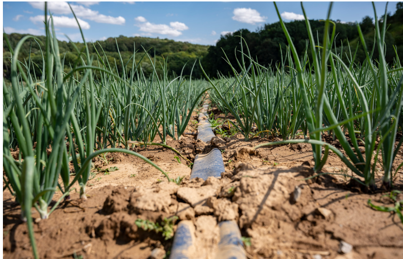
Abb. 5: Tropfbewässerungsanlagen sind anfällig gegenüber Leckagen; die wichtigste vorbeugende Maßnahme ist die vollständige Bedeckung der Tropfschläuche mit Erde (© ALB)
