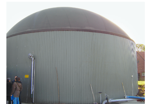
Bild 10: Das produzierte Biogas wird in einer einschaligen Membran über dem Fermenter gelagert und entschwefelt (Bioenergie Schulte Spechtel)
