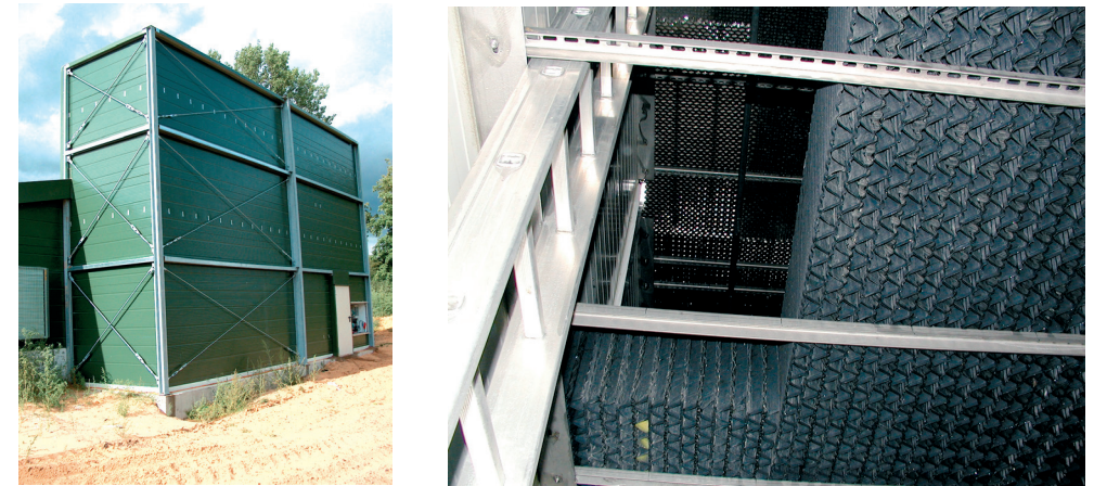
Abb. 2.2: Abluftwäscher (links: Außenansicht, rechts: Innenansicht mit Füllkörpern)
