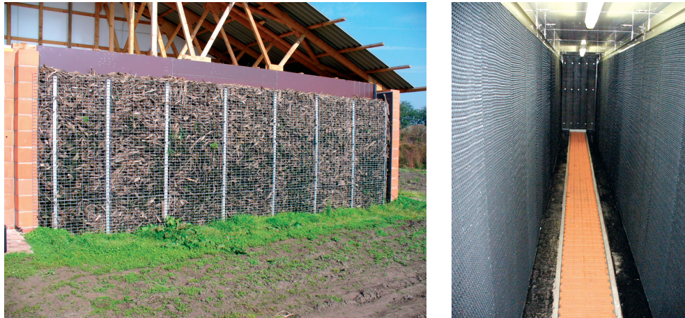
Abb. 2.3: Mehrstufige Abluftreinigungsverfahren (links: Außenansicht mit Biofilterwand, rechts: Innenansicht mit Filterwänden)
