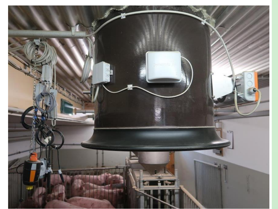
Abb. 5: Abluftkamin mit Sensoren
